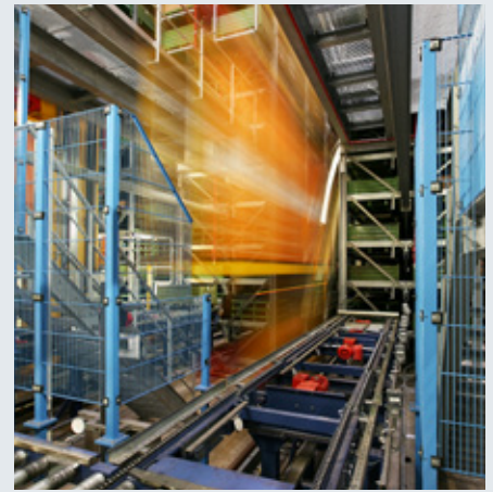
Die moderne Anlage zeichnet sich durch Energieeffizienz und niedrigem Verbrauch bei hoher Leistung aus.
