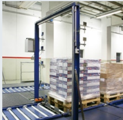
Für die Warenverteilung installierte MLOG Barcode-scanner in beiden Lagern. Durch das automatische Erfassen konnte der Durchsatz für die Palettenein- und -auslagerung gesteigert werden.
